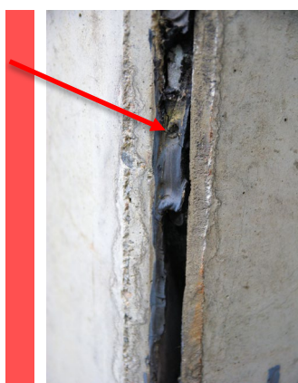
Figur 10 Asbestholdig fugemasse mellom betongelementer.
