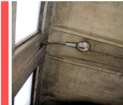
Figur 16 Eksempler på belysningsarmatur med kvikksølv i bygget.
