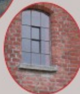
Ved restaurering av gamle låver bør man prøve å bevare slike vindusdetaljer. Krødsherad Foto: I.J.J.
